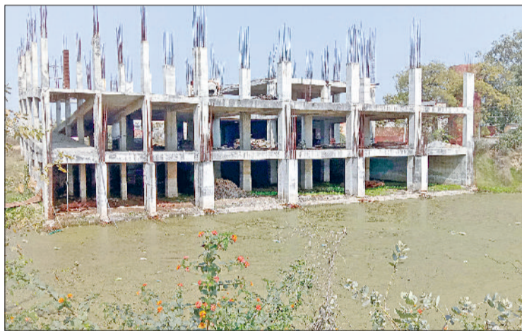
नारनौल। अधूरा पड़ा 200 बैड का सात मंजिला भवन।
